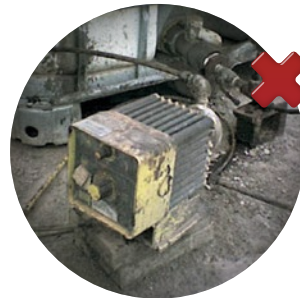
Inadecuado soporte e incorrecta instalación de tuberías hidráulicas
