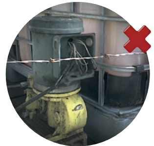
Inadecuado soporte e incorrecta instalación eléctrica
